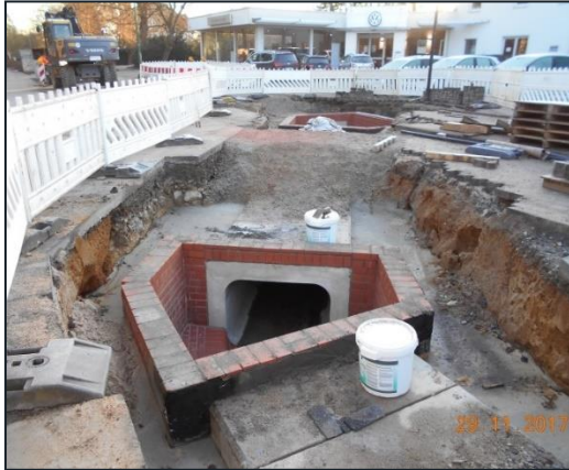
Durch Rückhaltung über Stauraumkanal
